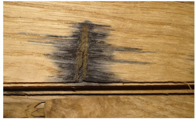
Oxidationsfleck aufgrund des vorherigen Vorhandenseins von a Eisennagel Tache d'oxydation due à la présence antérieure d'un clou en fer.
